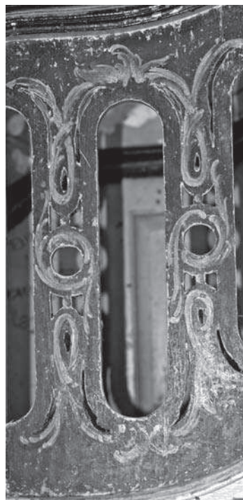
Ryc. 5. Odsłonięta dekoracja malarska jednej z tralek klatki schodowej
